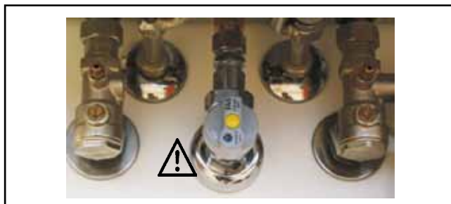
Ábra: gázcsatlakozás: a kiáramló gáz mérgező, robbanást
